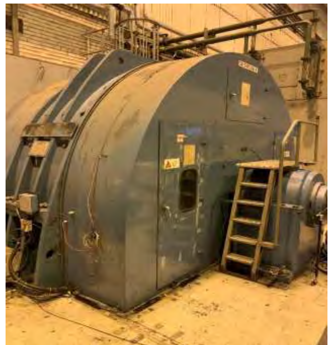
Valssituolin F4-päämoottori suojaelitteineen
