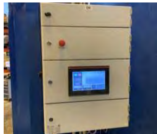
Kuivausuunin uusi ohjauskeskus
