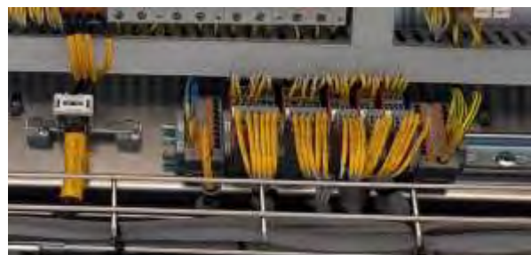
Kaapeli- ja johdinmerkintöjä ja riviliitinkytkentöjä raitiovaunussa
